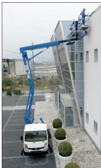
Piattaforma di lavoro mobile elevabile autocarrata (B1)
